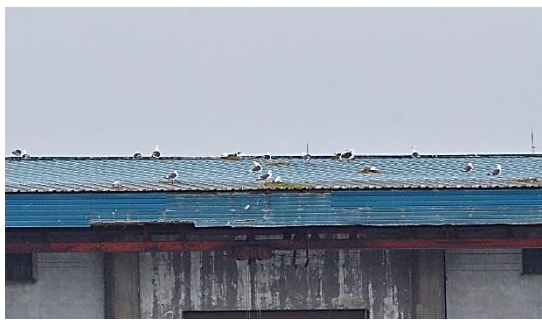
被害が問題化していた倉庫 2015年5月26日撮影
